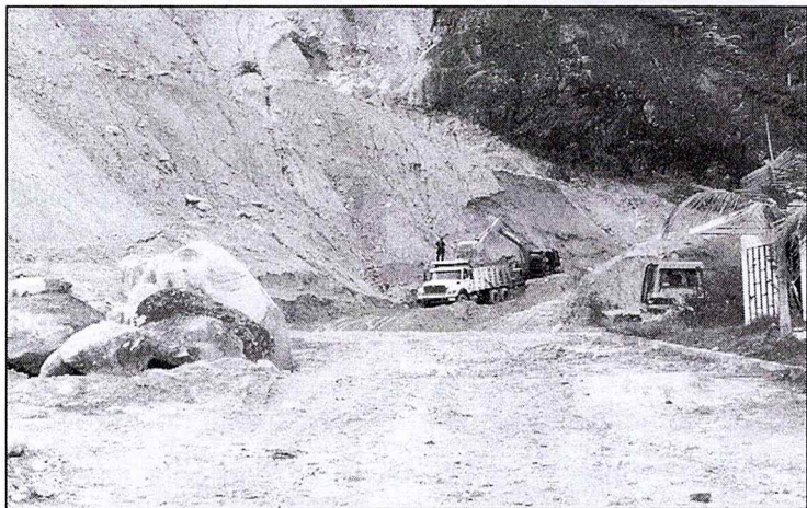
figura 2. Maquinaria pesada operando en la cantera El Palmar - zona no autorizada por Cornare Foto extraída del Informe técnico No. IT-01811 del 18 de marzo de 2022.
