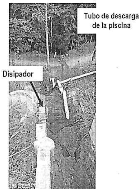
Imagen 2. Disipadores de energía hidráulica y tubo de desagüe de la piscina
