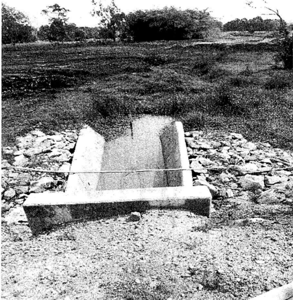
Fotografía No 5- Empozamiento de aguas residuales descarga del Box Coulvert Visita del 15 de noviembre de 2021.
