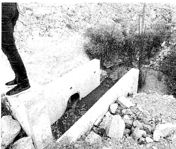
Fotografía No 3- Descarga aguas residuales visita realizada 27 de septiembre de 2021
