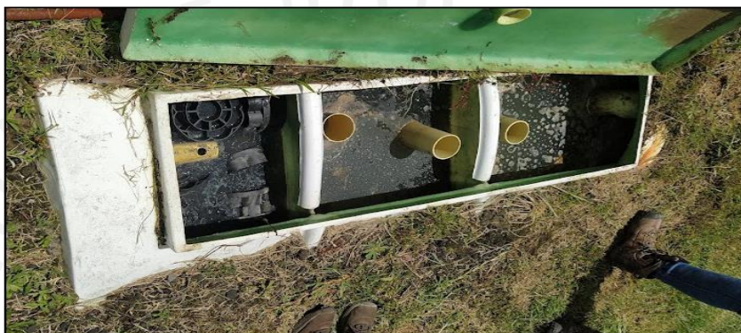
Foto No 5: STARD zona de portería, en funcionamiento
