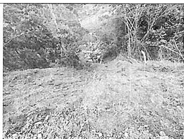
Imagen 10. Talud erosionado, depositando sedimentos al río Dormilón.
