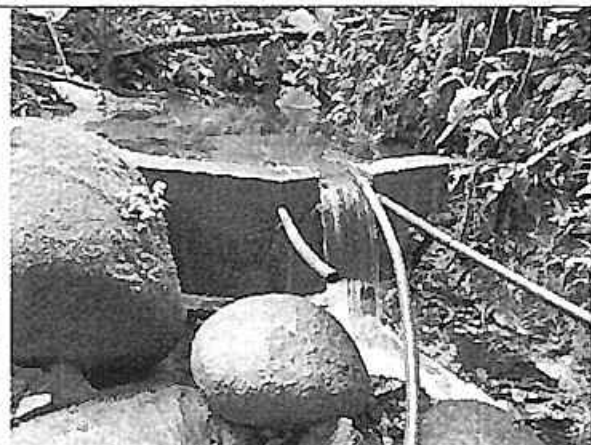
Imagen 14. Obra de captación de donde se conduce el recurso hasta los tanques.
