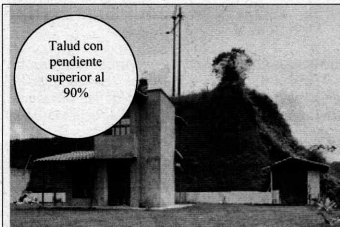
Fotografía 5: El Talud colindante del señor Restrepo, presenta una inclinación del 90%.
