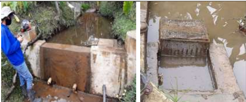
Figura 2. Captación Fuente Arroyo Bedoya Ramal 1
