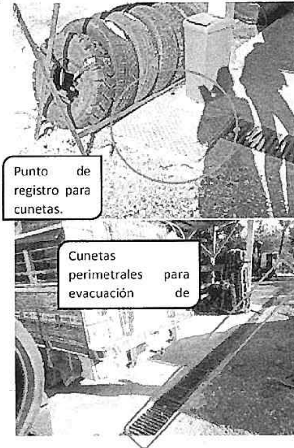
Imagen 1. Punto de registro y cunetas perimetrales para la evacuación de escorrentías a canal adyacente al predio. Fuente Cornare 2021.
