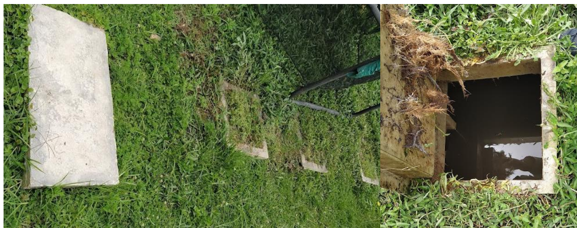
Foto No 2: Estado de funcionamiento pozo séptico.
