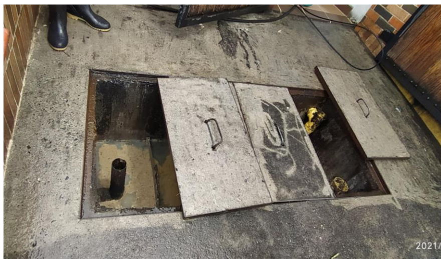
Foto No 1: estado de funcionamiento trampa de grasas
