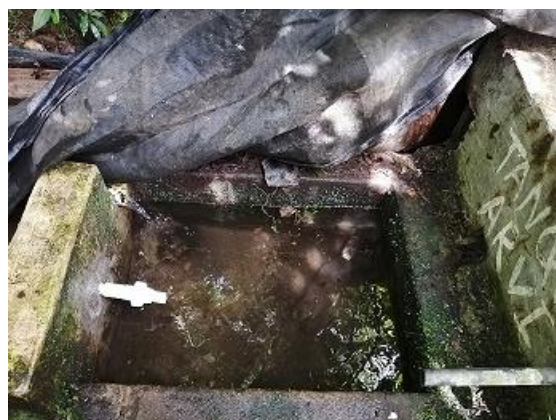
Imagen 2. tanque de control
