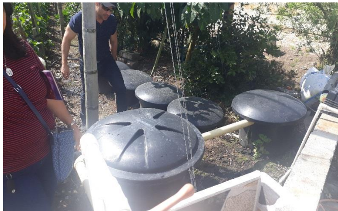
Figura numero 2: Sistema de tratamiento de Aguas Residuales no domésticas.
