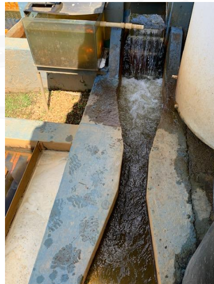
Ilustración 4. Canaleta de Parshall
