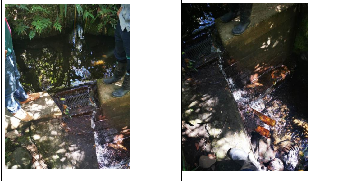
Imagen 3 y 4. Obra de captación implementada sobre la fuente Los Benitos.
