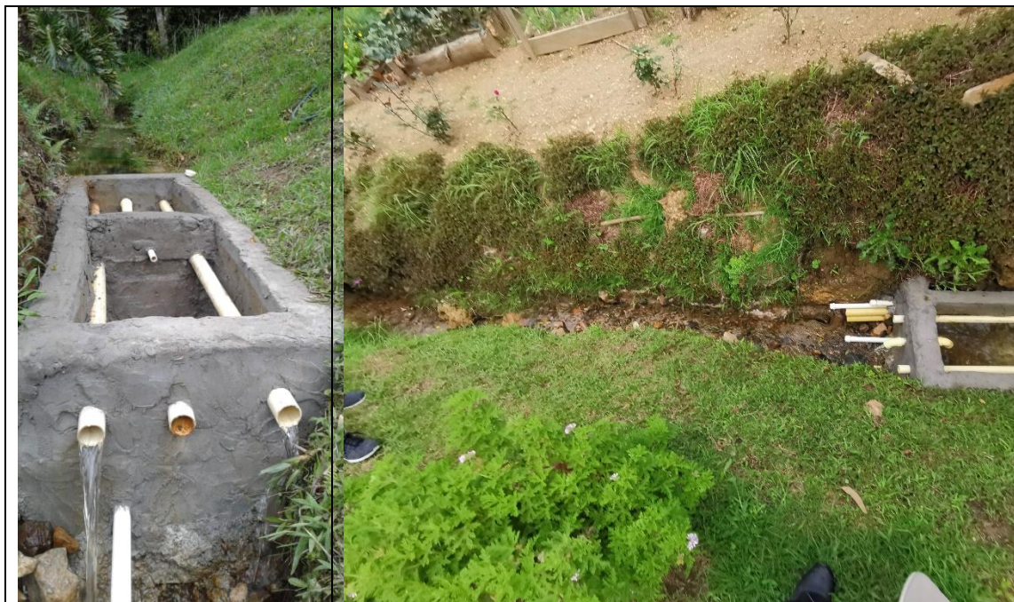
Imagen 1. Obra de captación y control de cadual implementada en la fuente Los Girasoles.
