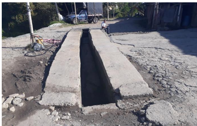
Ilustración 1. Cárcamo de lavado de vehículos.
