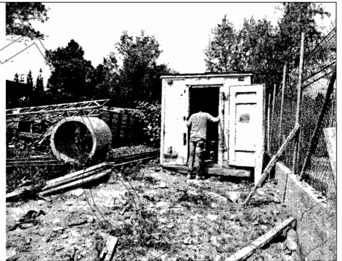
Foto No.4. Los predios fueron cercados perimetralmente con malla. Dentro de los predios se han venido almacenando residuos de madera.
