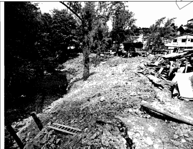
Foto No.3. Se evidencia que no se ha recuperado la cota natural de la margen derecha de la quebrada La Mosca, existente antes de la
