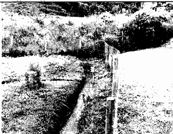
Foto No.1. Se observa el sitio de ingreso de la fuente hídrica a la tubería, la cual se observó con sedimento y residuos vegetales que impiden el flujo normal del agua.
