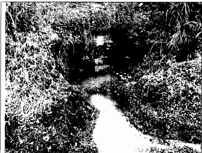
Foto No.3. Se observa la obra transversal de la vía Rionegro – El Carmen totalmente obstruida, generando represamiento de la fuente hídrica.
