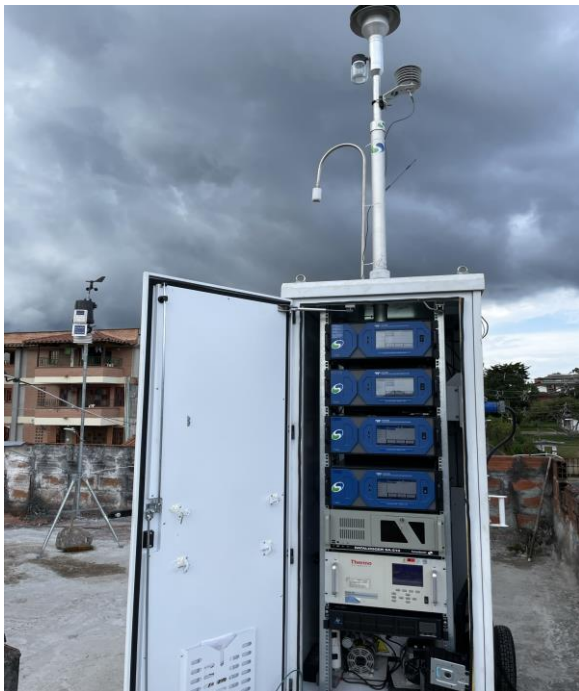
a. Equipos instalados en el punto de monitoreo
