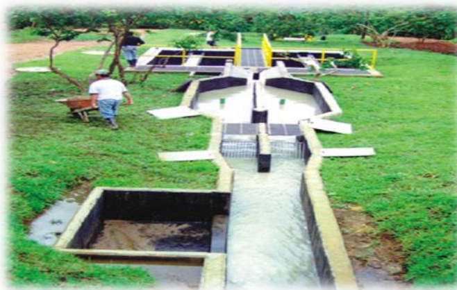
Foto 7. Planta de tratamiento de Aguas residuales
