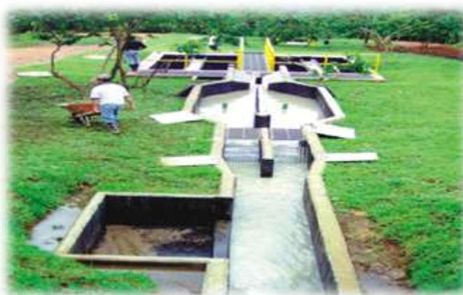
Foto 7. Planta de tratamiento de Aguas residuales
