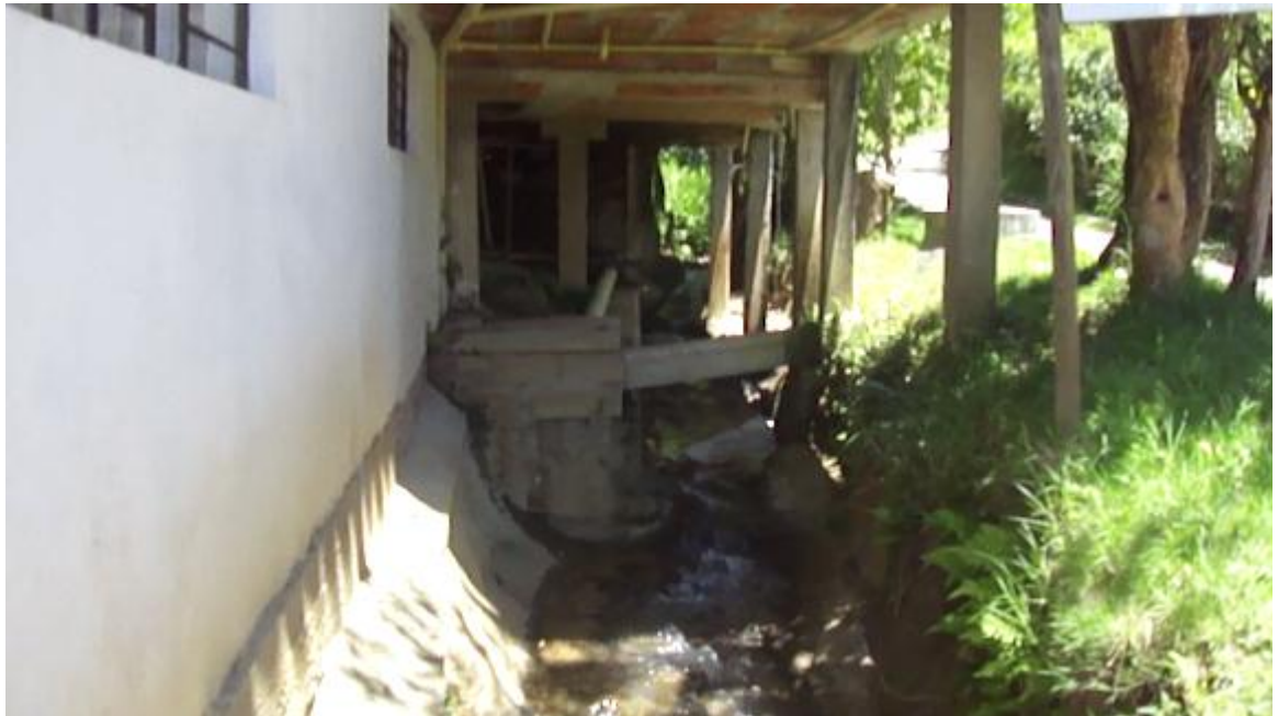
Figura 4. Vivienda sobre el cauce de la quebrada Basto Sur.
