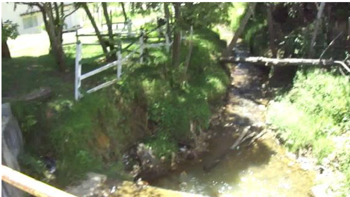
Figura 2. Quebrada Basto Norte con sección ocupada por arboles y escombros.
