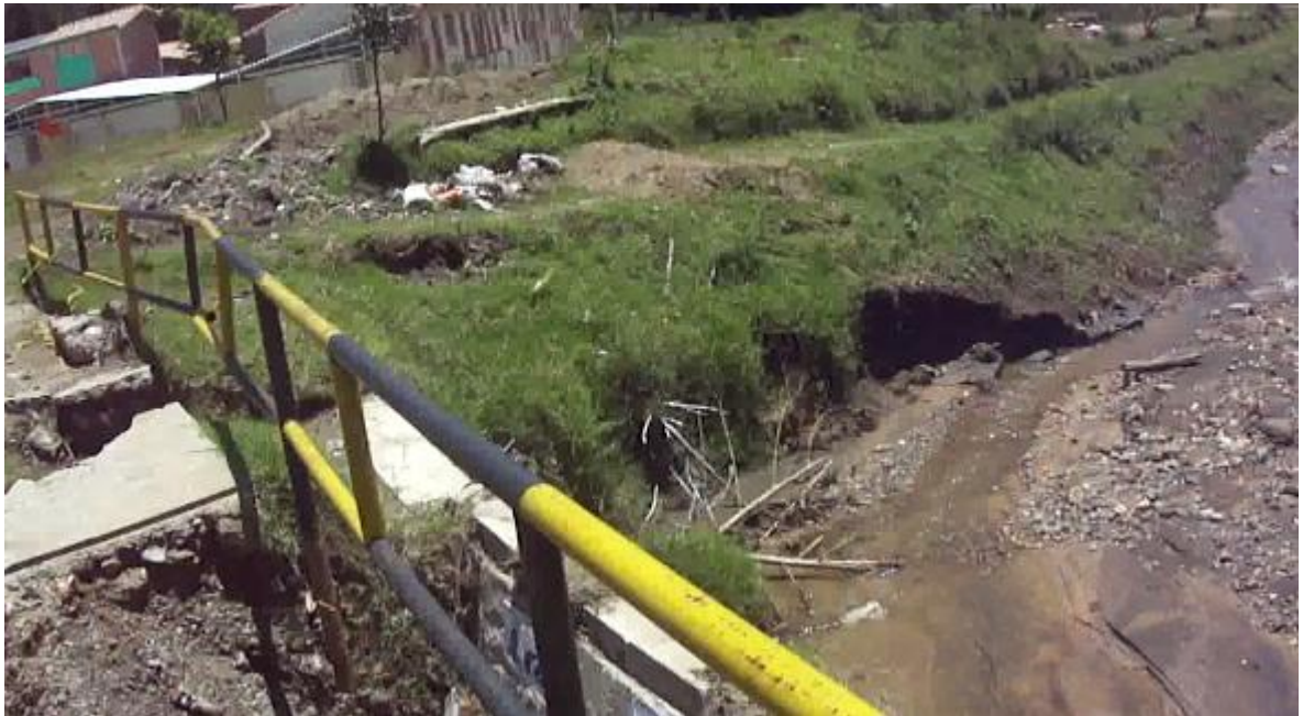
Figura 5. Colapso de obra hidráulica en quebrada La Felipa, Municipio de Guarne Antioquia.
