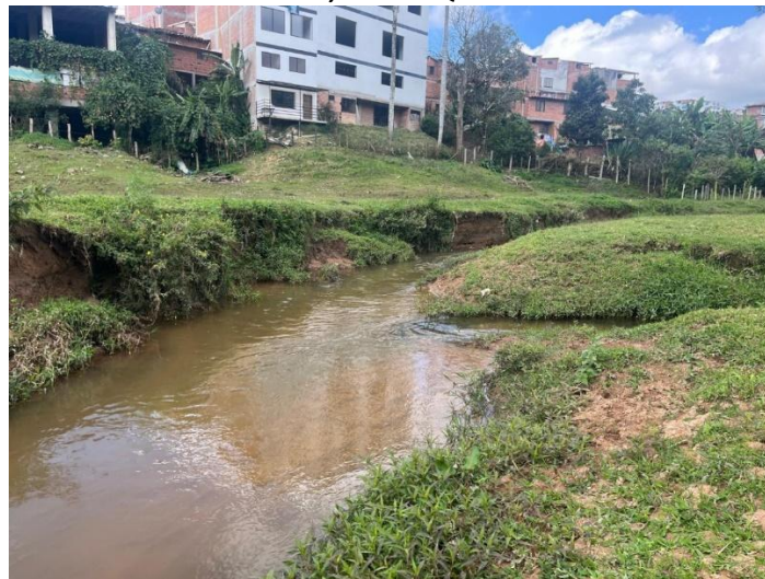
Figura 64. Socavación lateral, Unión Quebrada la Palma - El Salado.
