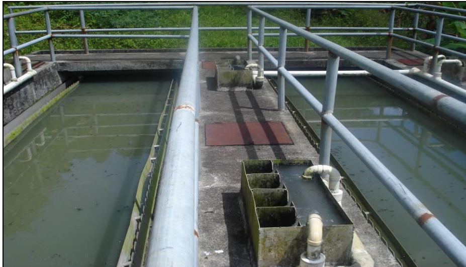
Foto 4. Sedimentadores de alta tasa. El Cascajo o Planta No. 2. Municipio de San Francisco.
