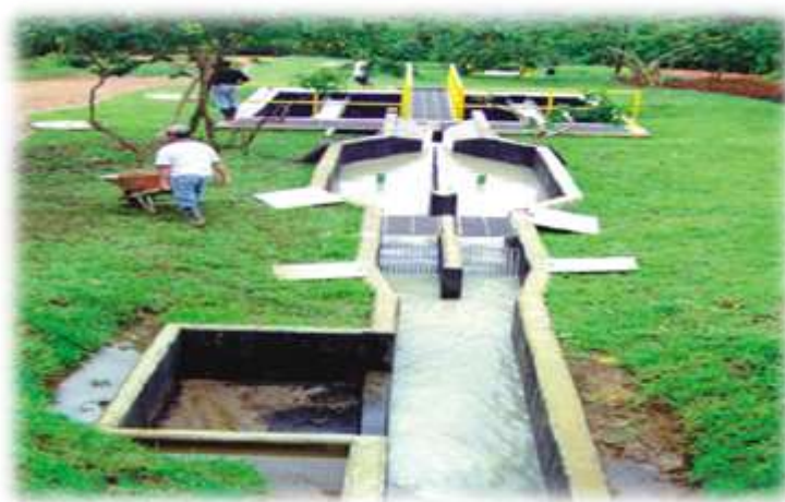
Foto 7. Planta de tratamiento de Aguas residuales
